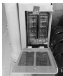
Caixa de fusíveis principal da cabina LX e DLX
